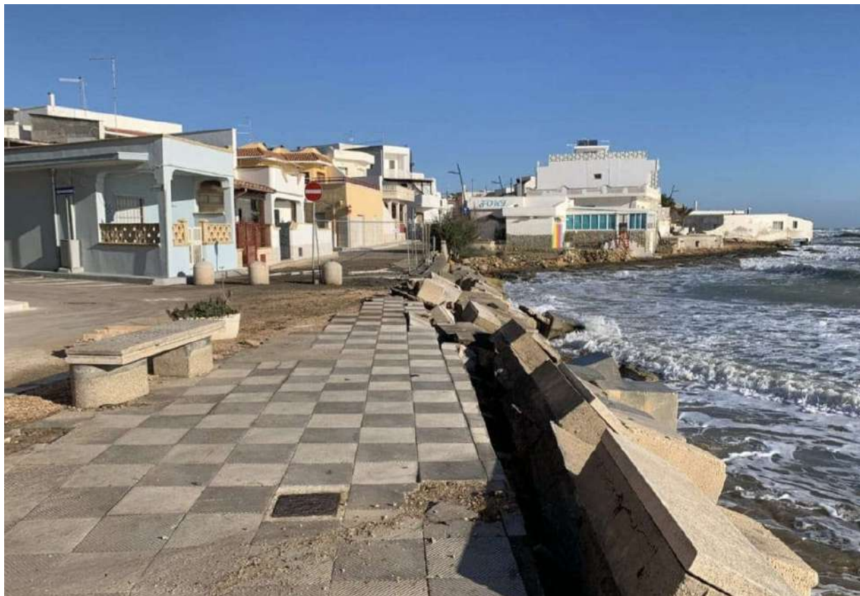
Figura 5.31: Danneggiamenti in seguito a mareggiata – Comune di Torchiarolo
